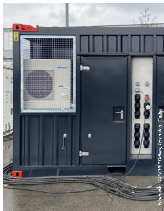
PACi Außeneinheit von Panasonic ist im Container durch ein Gitter geschützt untergebracht
