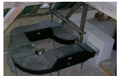
Das im Dachboden installierte Kanalgerät
