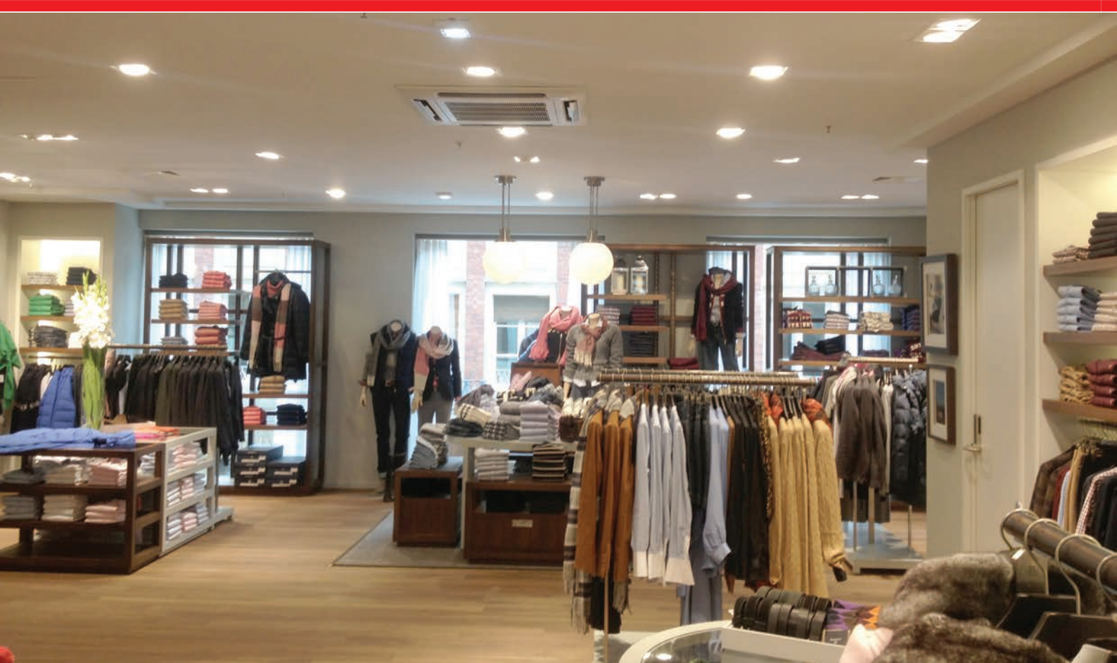
4-Wege Deckenkassette im Verkaufsraum, bei hindernisfreiem Einbau entspricht der Wurfweitenbereich der Kassette einem Radius von ca. 8 m
