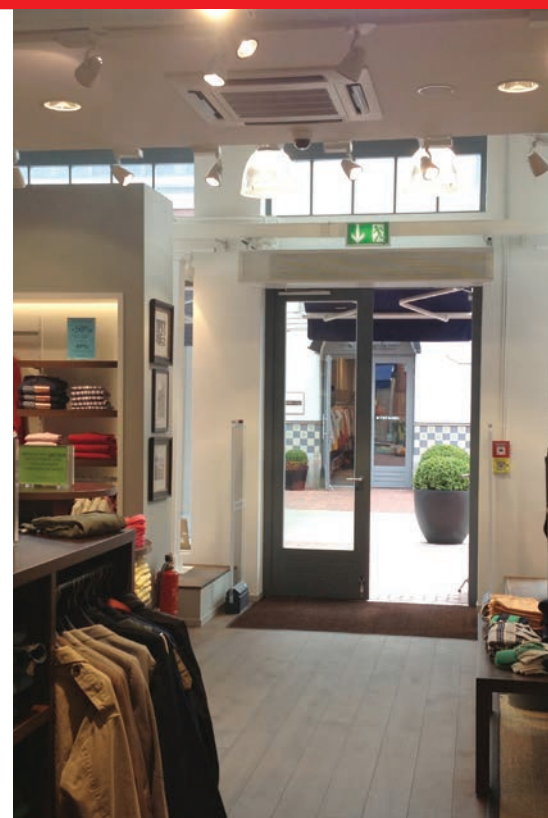
Eingangsbereich inkl. Türluftschleiersystem, im Vordergrund ist die 4-Wege-Deckenkassette zu sehen.
