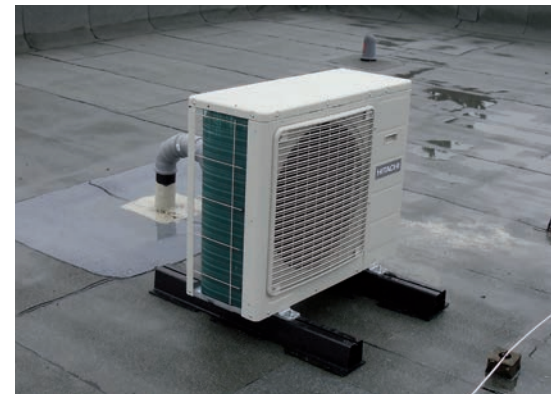
Eine RAM-90 oben auf dem Dach montiert.
