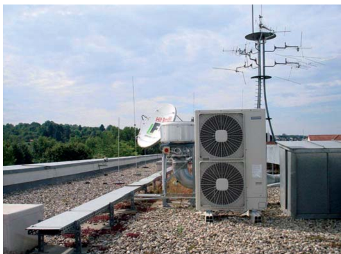
Außeneinheit auf dem Dach des hessischen Senders
